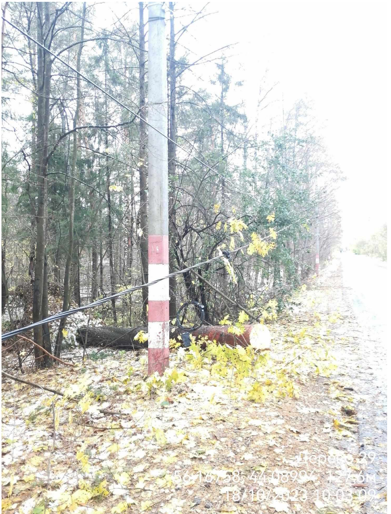
Дерево 29 – упало на дорогу и провода, с дорожного полотна часть дерева убрана незамедлительно
