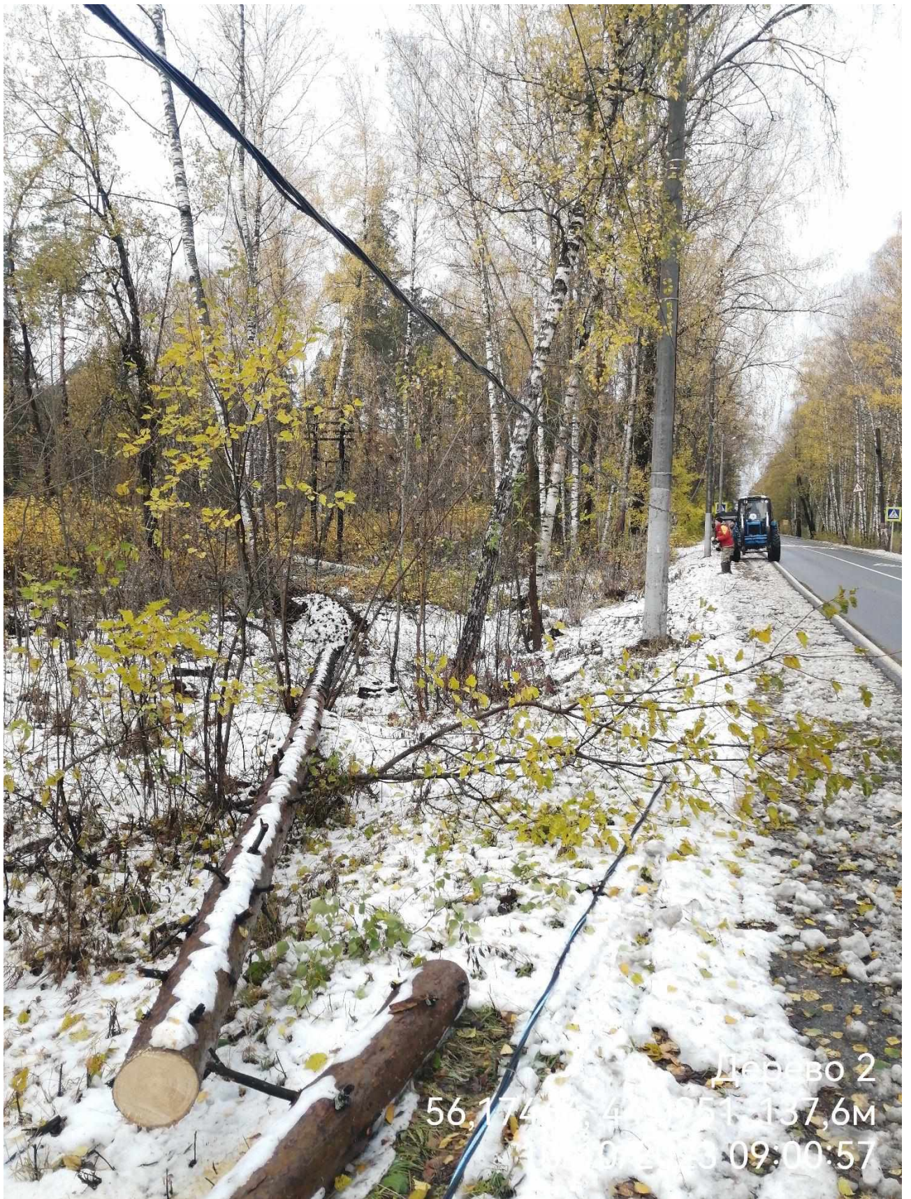
Дерево 2 – упало на дорогу и провода, с дорожного полотна часть дерева убрана незамедлительно
